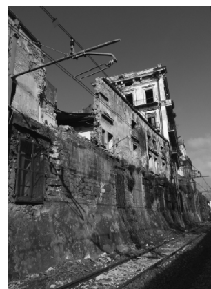
国鉄ローカル線 崩れた屋敷とその真下の鉄路
